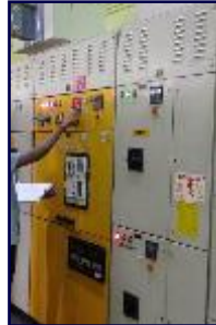
Substation Parameter Monitoring
