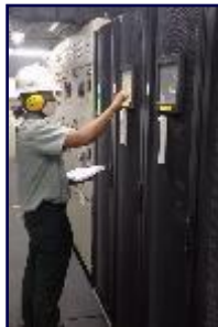
UPS Parameters Checking
